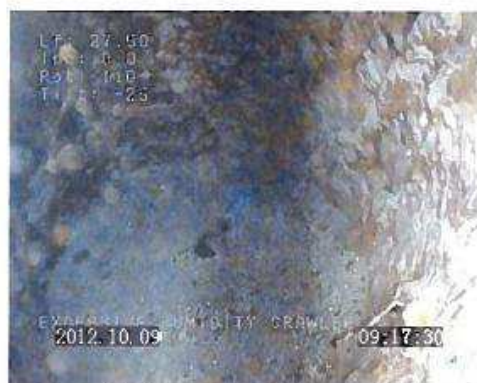
Fond de l'ouvrage comblé par du dépôt
